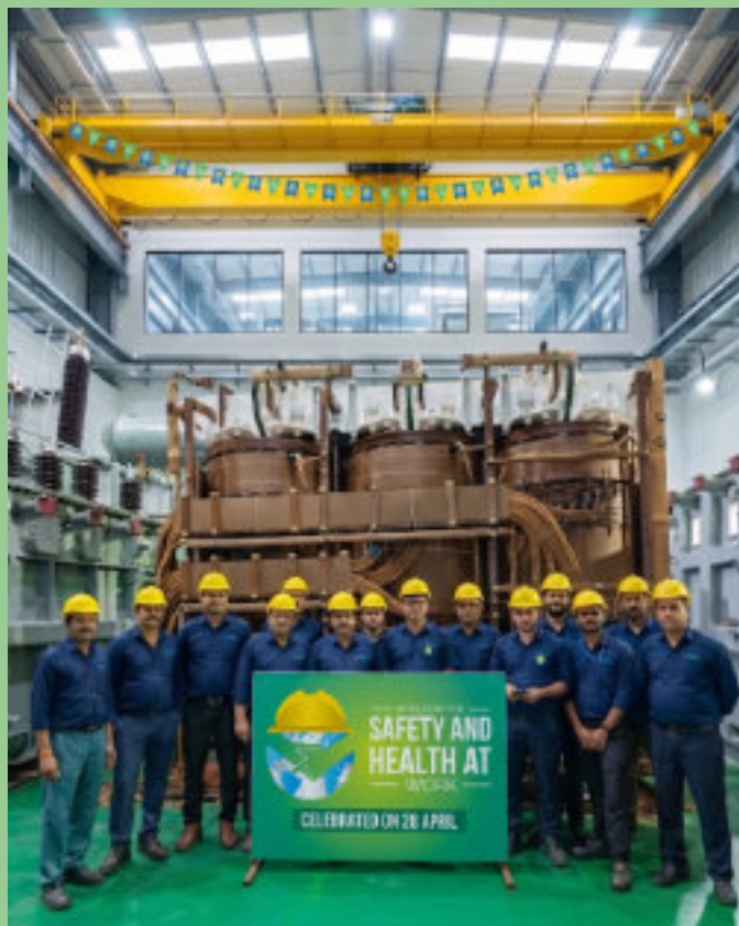
Montagem da parte ativa (CC) - 50 MVA, Classe 132 kV
