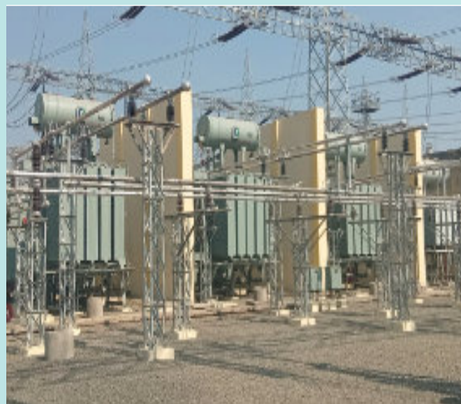
Subestação de 400 kV comissionada em 2025-26
