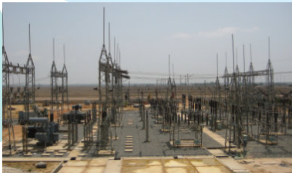
Pátio de manobra (switchyard) de 132 kV comissionado em 2025-26
