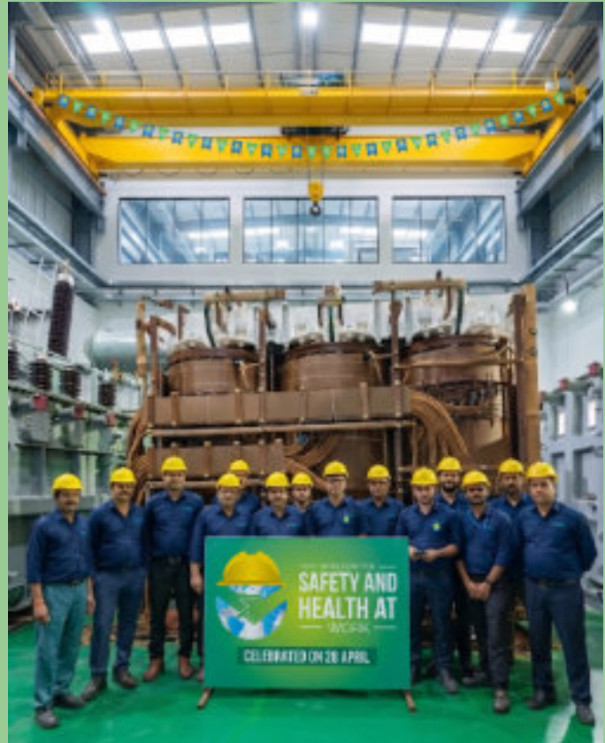
Ensamble de la parte activa (CC) - 50 MVA, Clase 132 kV
