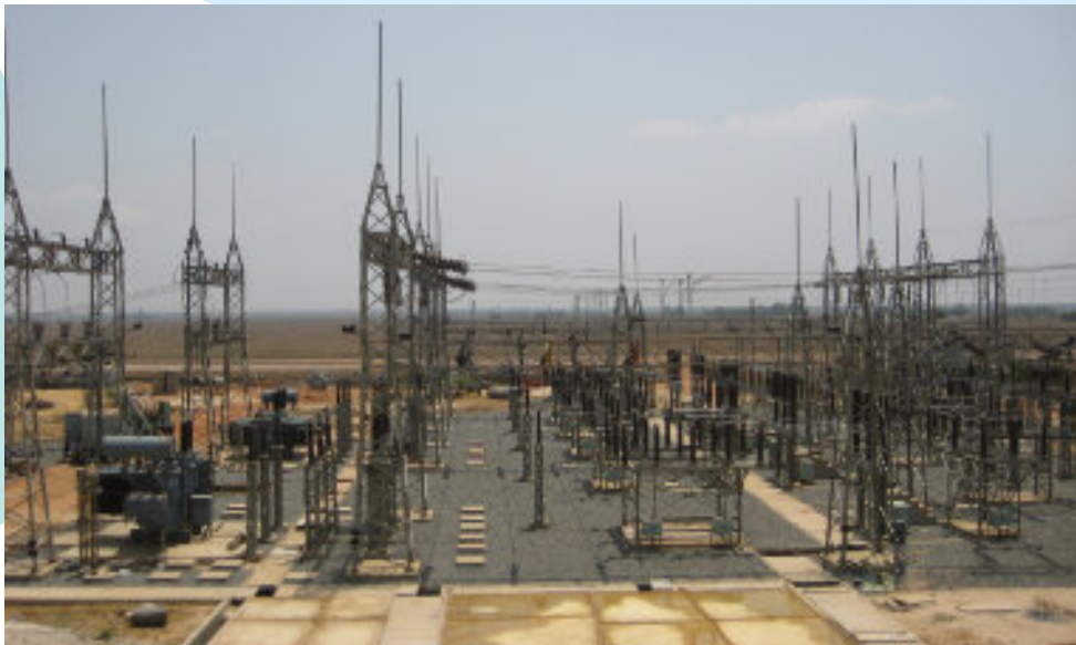
Patio de maniobras (switchyard) de 132 kV puesto en marcha en 2025-26
