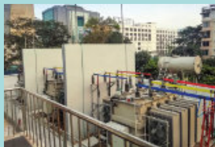
20/28 MVA, 33/11 kV: Transformador de potencia suministrado a DESCO, Bangladés.
