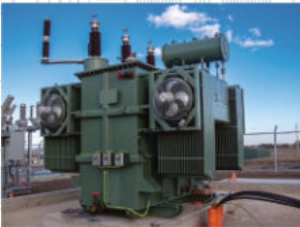
Transformador de 12.5 MVA, 66 kV suministrado a Australia
