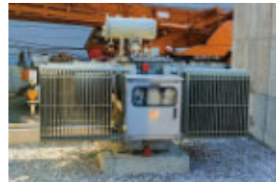
Transformador de potencia de 12,5 MVA, 60 Hz, suministrado a Corea del Sur .
