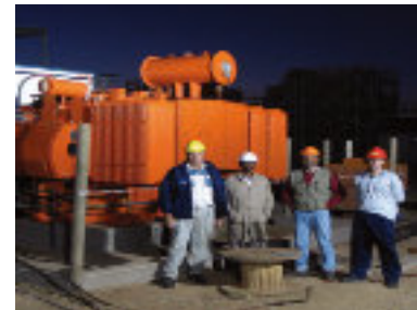
Transformador de 7.5 MVA instalado en la mina de diamantes De Beers, Namibia .
