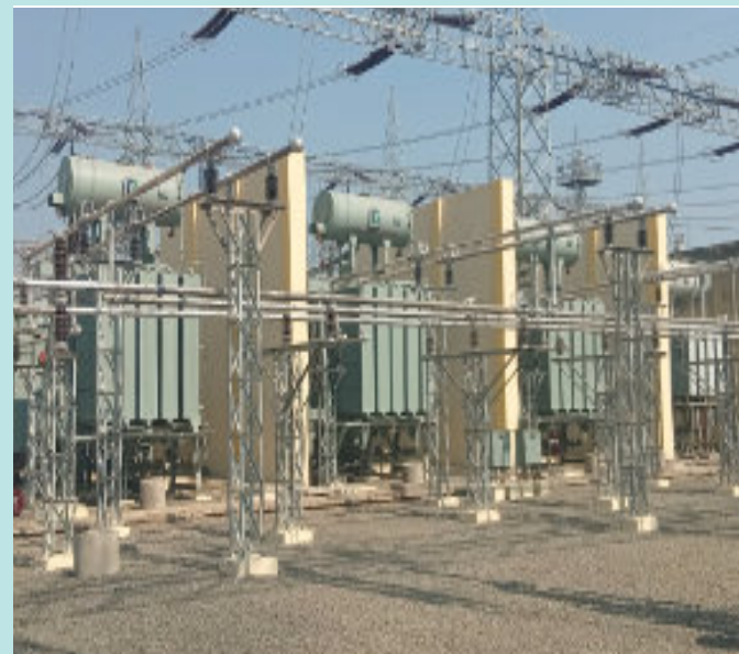
Subestación de 400 kV puesta en marcha en 2025-26
