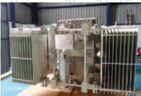
Transformador de servicio de 2 MVA, 13,8/0,48 kV, 60 Hz suministrado a Texas, EE. UU.
