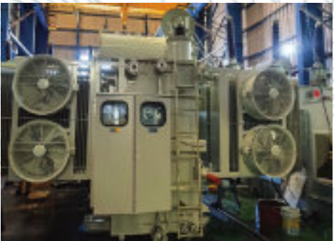
Transformador de relación unitaria de 25/35 MVA, 13,8/13,8 kV, 60 Hz suministrado a Texas, EE. UU.
